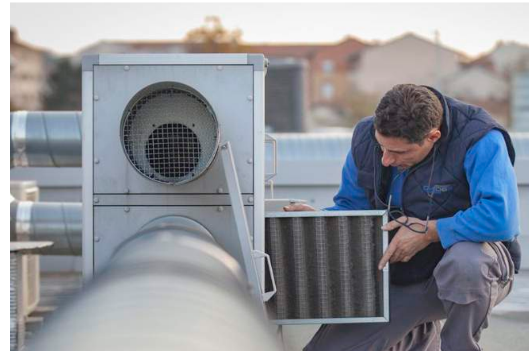
Eclairage et climatisation concession Mercedes et maintenance
