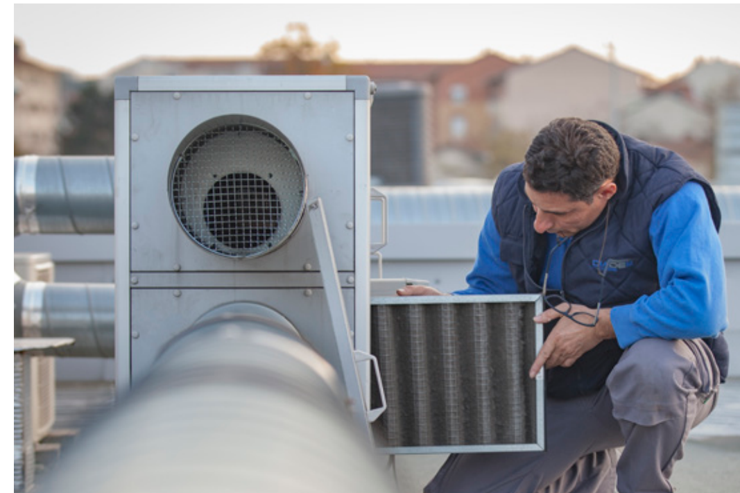
Eclairage et climatisation concession Mercedes et maintenance
